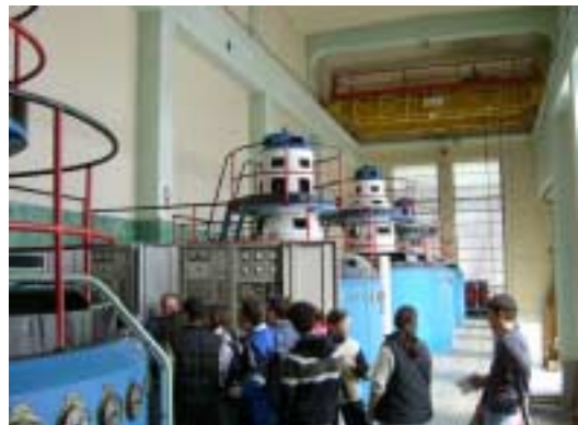
Tra i generatori
