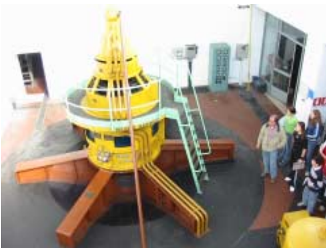
Nel locale macchine
